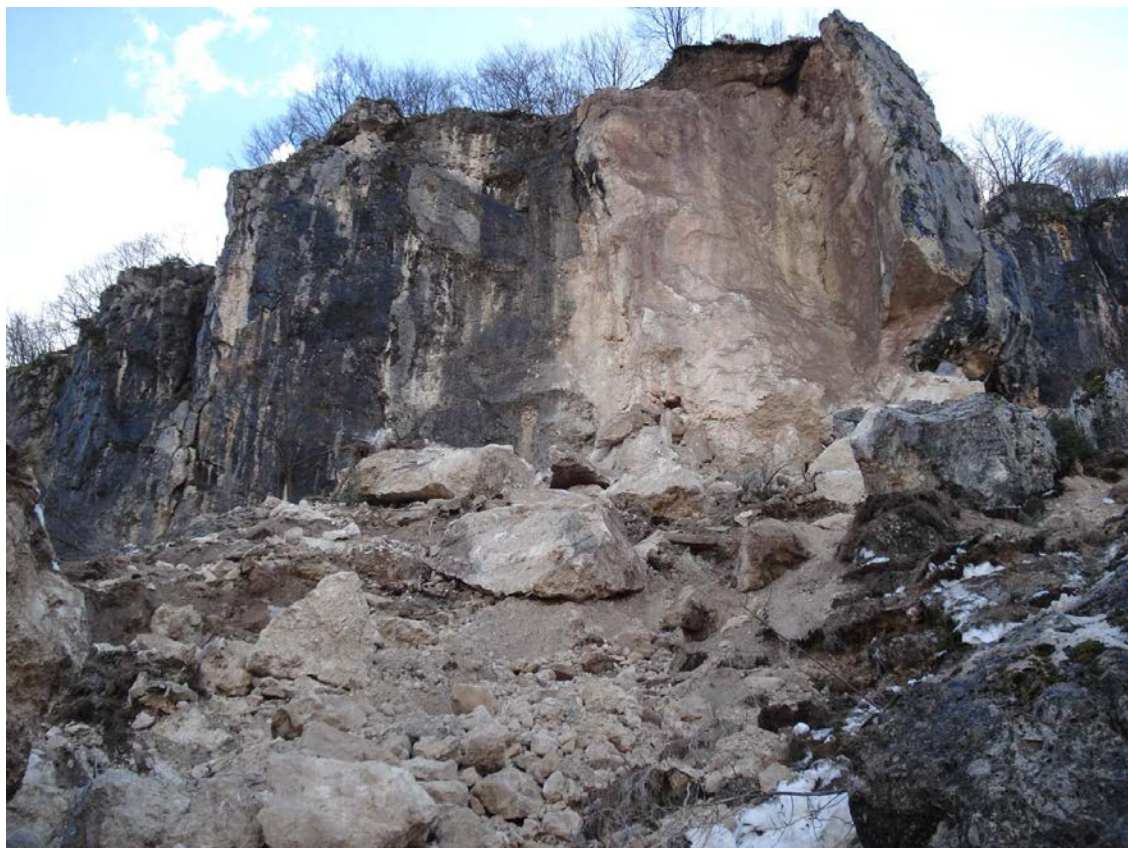
Fig. 9 - Particolare della nicchia di distacco della frana di crollo di Capo le Vene.
